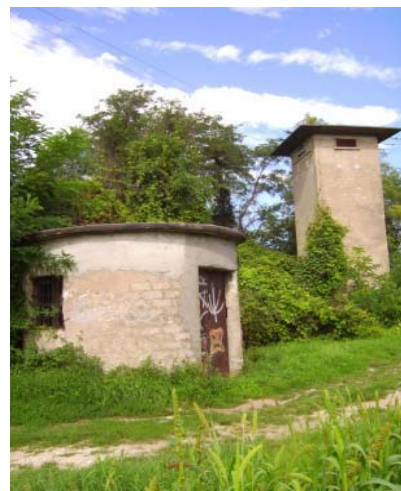
Strutture a torretta e di forma circolare utilizzate per la captazione delle acque direttamente dalla falda realizzate sull'area del fontanile (foto Beretta).
